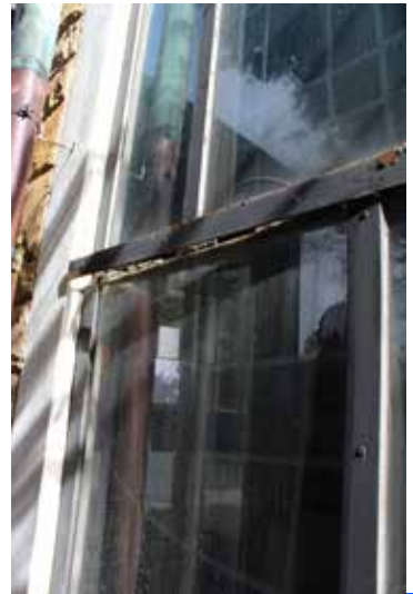
Die Schäden an der Fassade sind nicht zu übersehen. Foto: F.Hans
